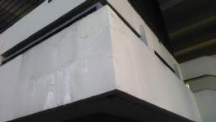
Schäden an der Betonfassade
