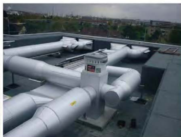
Leitungsführung der Lüftungsrohre über Dach
